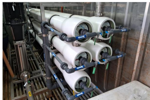
Osmosis inversa para agua potable rural en Quintay.
